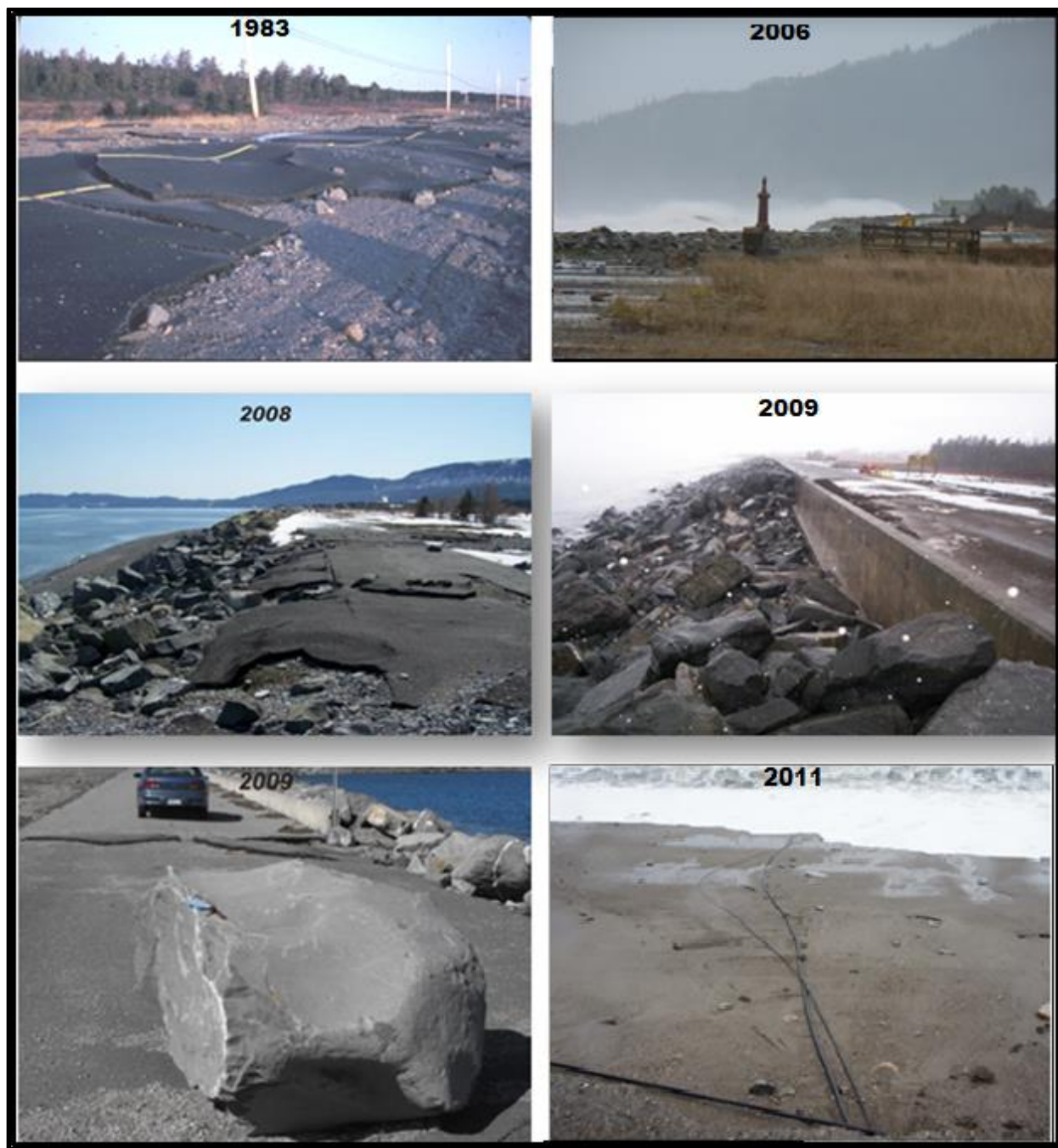
Figure 2. Dommages types observés au fil des ans sur la route du Banc et les infrastructures connexes – Source : Parcs Canada.
