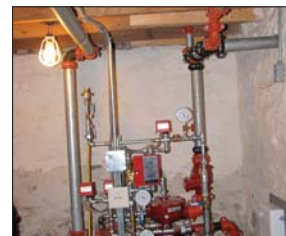
SYSTÈME D'EXTINCTION DES INCENDIES, SOUS-SOL DE LA MAISON DE PIERRE / PARCS CANADA / C. ARCHER / 2009
